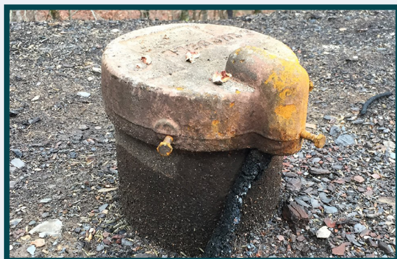
Una tapa de pozo dañada por un incendio. Foto: Center for Disease Control.
